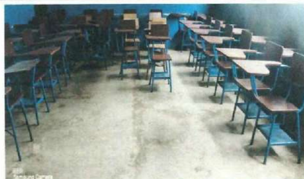
Foto 8: Se observa el deterioro y agrietamiento del piso de segundo básico.
