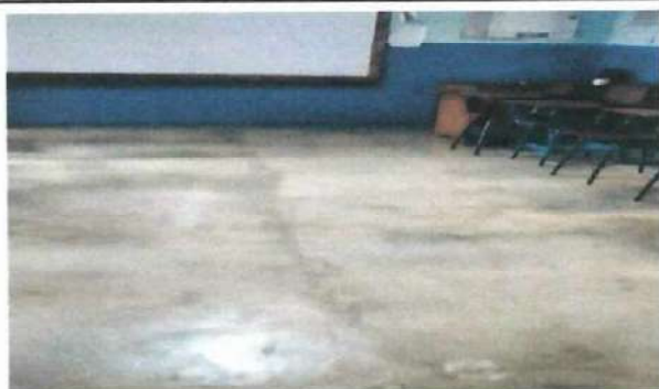
Foto 9: Se observa el deterioro y agrietamiento del piso de tercero básico.
