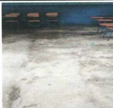
Foto 7: Se observa el deterioro y agrietamiento del piso de primero básico.
